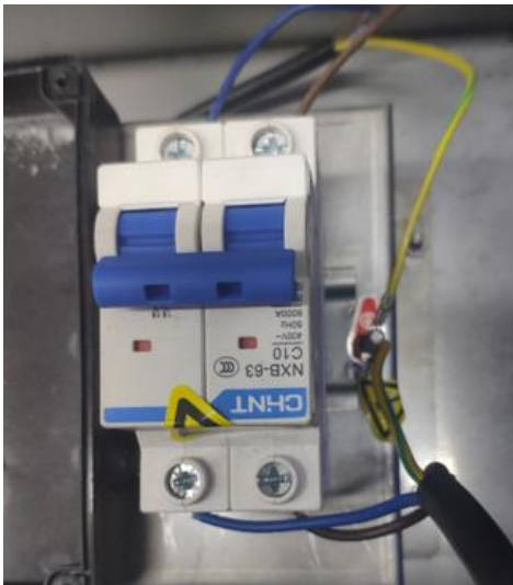
图5-6 系统进线实物图（电源线需自备）
