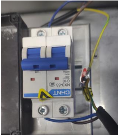
图5-6 系统进线实物图（电源线需自备）
